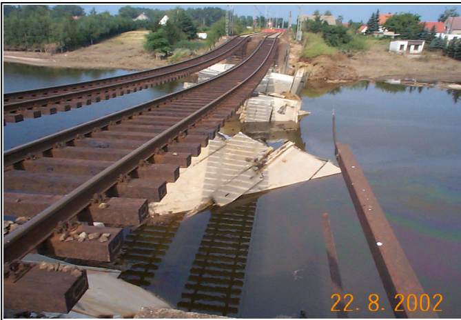
Zerstörtes Gleis an der ABS Leipzig - Dresden
